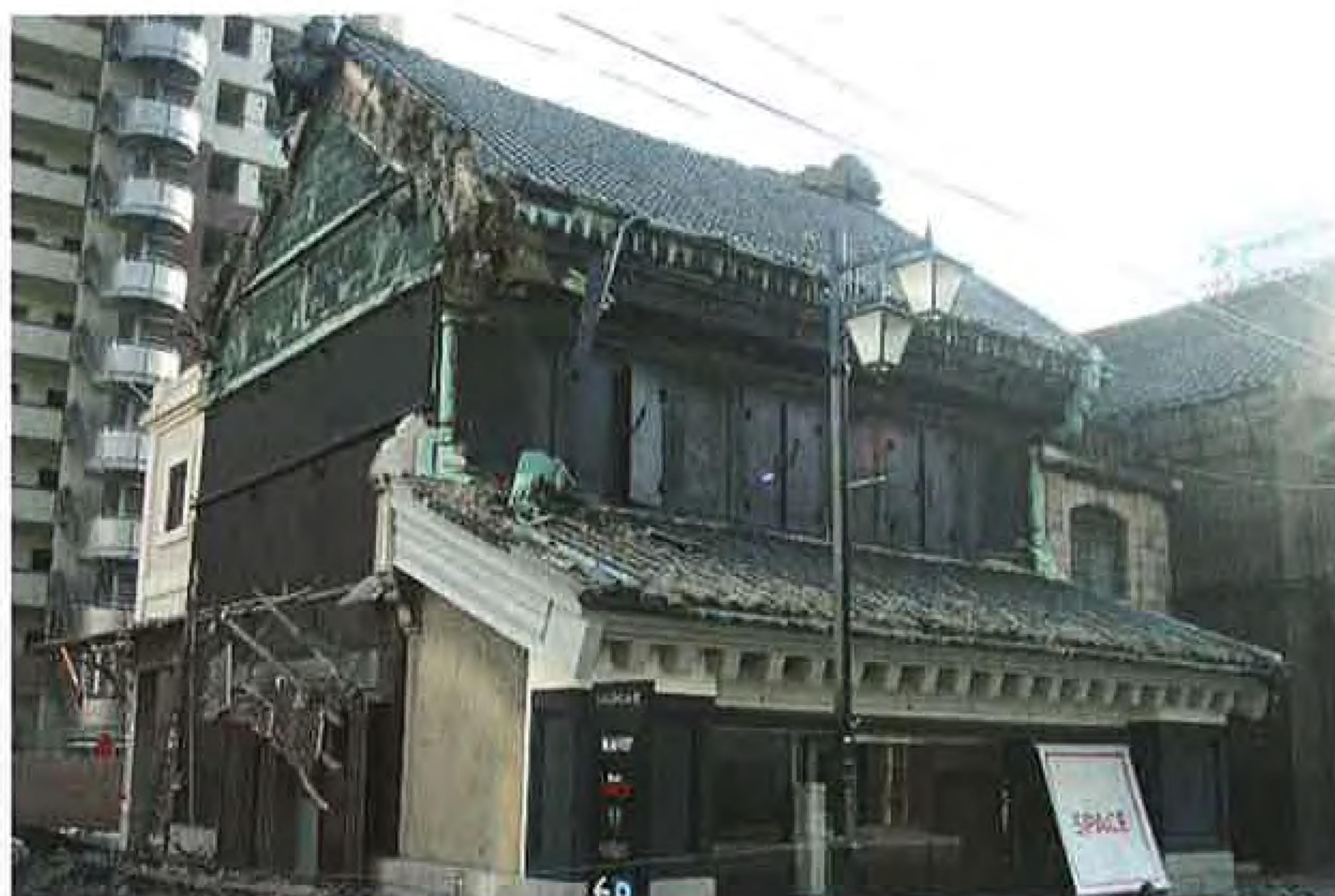
歴史的建造物の被害（旧釜屋） *2
