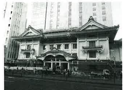
建設が急ピッチで進む東京・銀座の新歌舞伎座。上階は高層のオフィスビル
